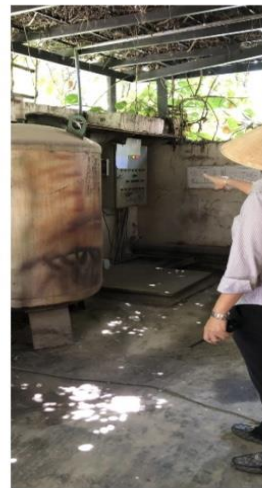
Xử lý nước thải
